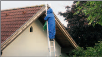
Hornissennest-Entfernung in der Zöbinger Straße
