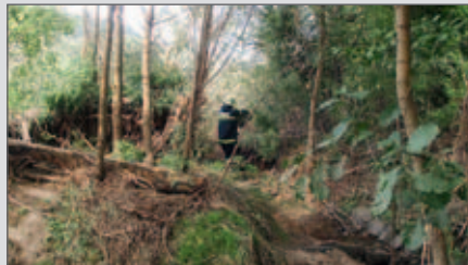
12.6.2010: Räumung einer Verklausung am Fahnbach
