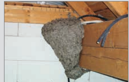
Ein Wespennest musste auf einem Dach in Zöbing entfernt werden.
