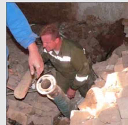
06.06.2007: Kellereinsturz nach Wassergebrechen bei Fam. Steindl - Auspumparbeiten
