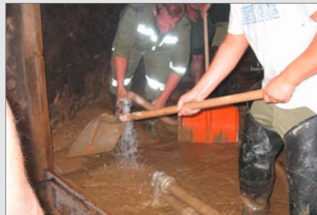
22.07.2007: Kellereinsturz durch Wassereintritt bei Gerhard Regelsberger
